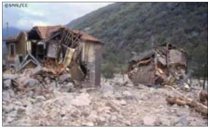
Abbildung 5: Casetti, frazione di Locana (17.10.2000). Die Unwetter im Oktober 2000 hatten verheerende Auswirkungen im Aostatal.
