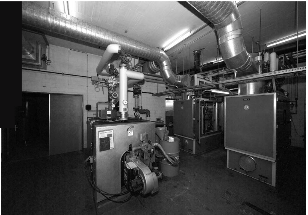
Blockheizkraftwerk, basierend auf Biogas aus der Kläranlage
