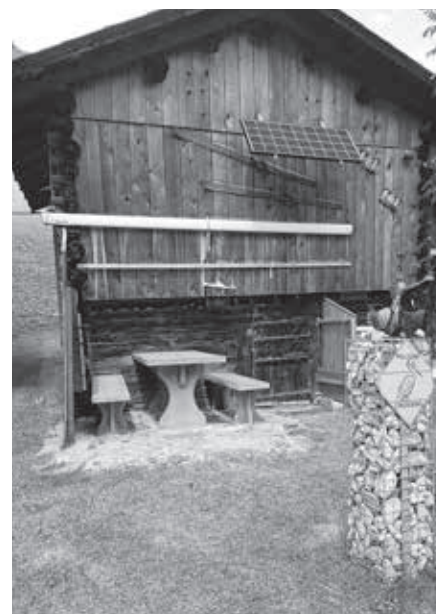
Panneaux solaires à Puzzatsch, dans le Val Lumnezia.
