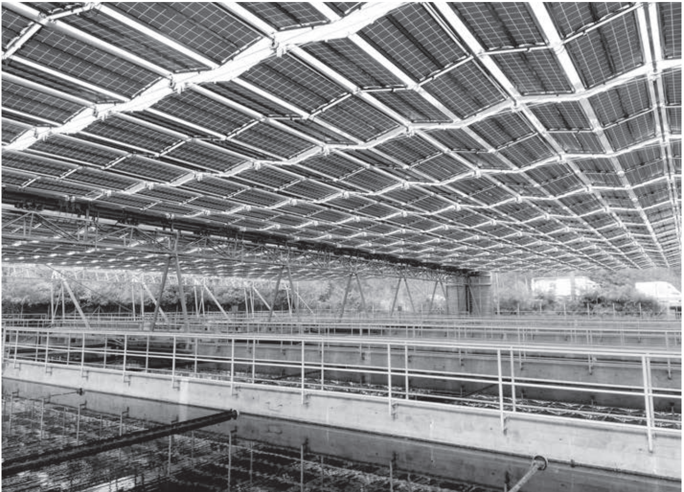
PV-Technologie der Schweizer Firma dhp Technology: Mit dem Solarfaltdach können Industriebauten wie hier die Kläranlage in Chur zur solaren Stromgewinnung genutzt werden.
