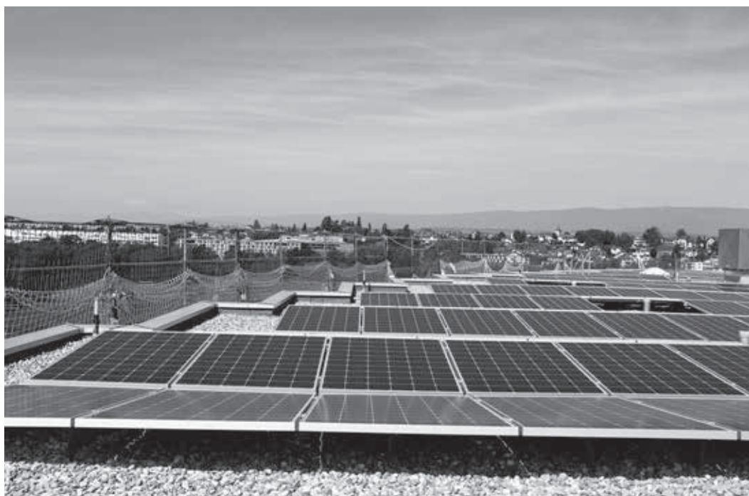
Panneaux solaires sur la résidence universitaire «Vortex» de l'Université de Lausanne et de l'EPFL.
